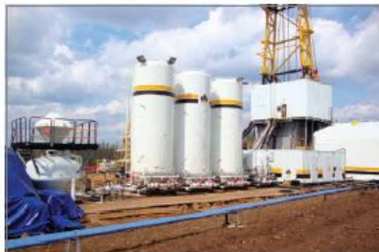
Стационарный склад ЗЦС-30
